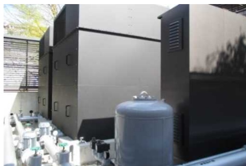
コージェネレーションシステムの一部
