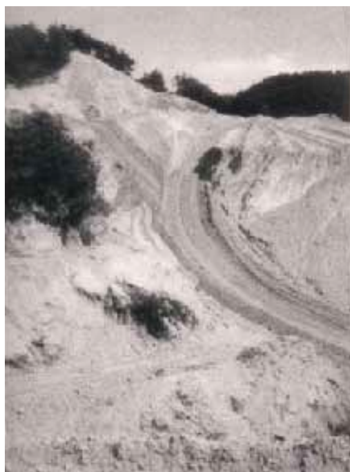
大至急の学舎づくり。ブルドーザーが、山肌を削った(昭和39年)。このあと緑に包まれたキャンパスづくりへの努力が重ねられた
